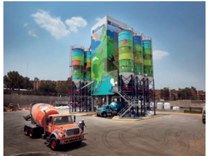
La planta de hormigón tipo torre está equipada con sistemas de última generación (incluida una mezcladora de hormigón de 2,5 m 3 )
