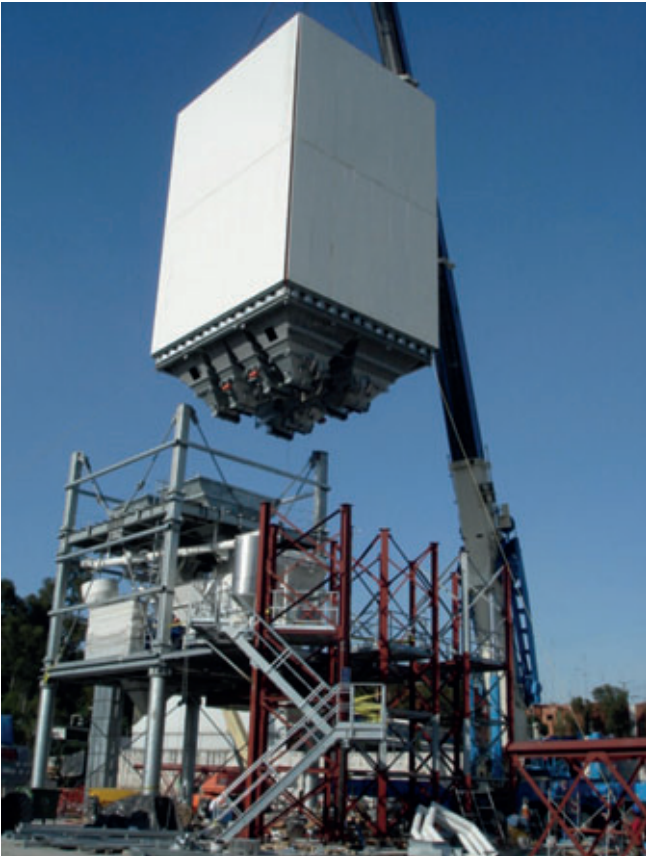
Sistema de almacenamiento de áridos con 8 tolvas con una capacidad total de 600 m 3
